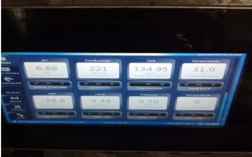
Online water quality monitoring system installed in River Cauvery காவிரி ஆற்றில் நிறுவப்பட்ட நீர் தர கண்காணிப்பு நிலையம்
